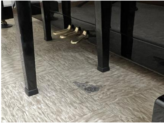
圖1 琴房地板鋪面貼皮老化剝落
