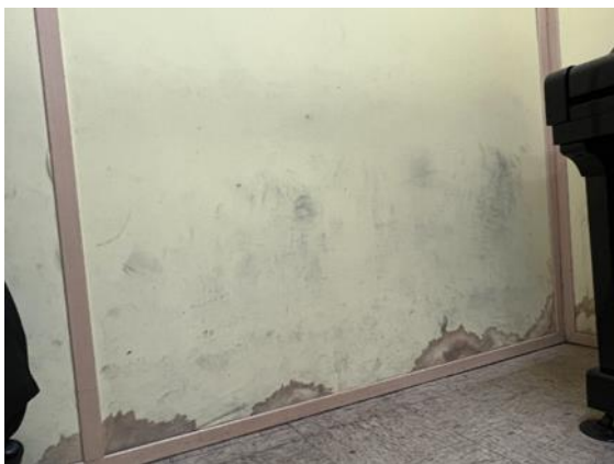
圖3 琴房牆面汗損須重新粉刷整理
