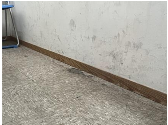
圖2 琴房地板鋪面貼皮老化剝落
