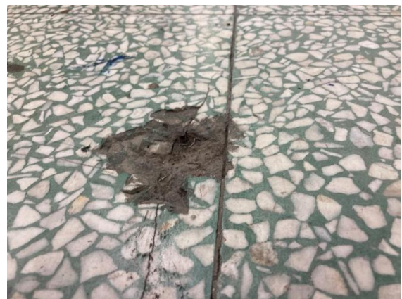
圖 6 設計教室多處磁磚破損及殘留鋼釘
