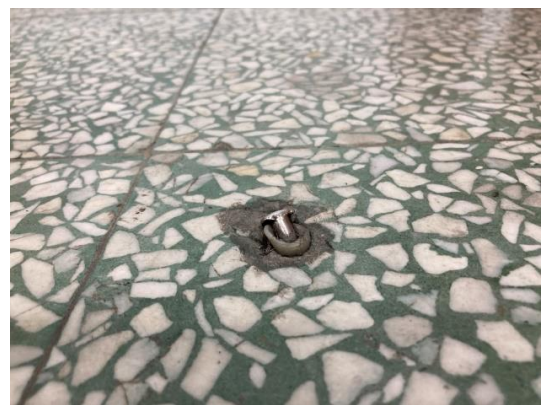
圖 6 製圖教室多處磁磚破損及殘留鋼釘
